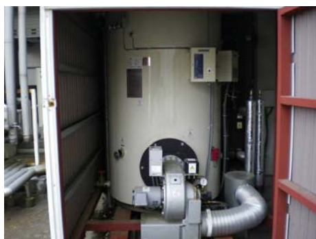
温泉施設ボイラー(上)
